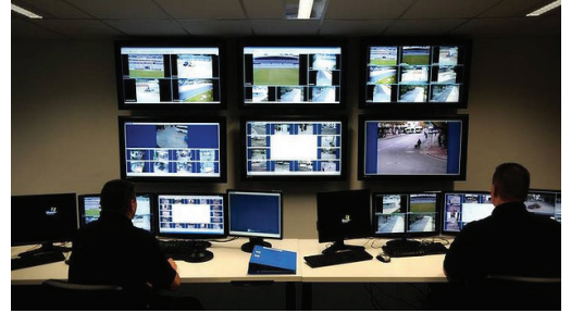
உரு 3.24 CCTV கமரா கட்டுப்பாட்டு கலையகத்தின் கண்காணிப்பு
